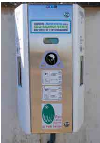
△ Installation de 4 bornes de recharge gratuites pour les voitures électriques
