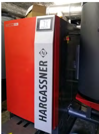
La chaudière bois de la Maison du Parc
