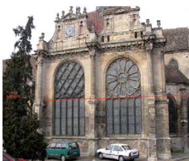
Fig. 6 - Niveau de la frange capillaire à l'église de Magny-en-Vexin que détermine la zone plus altérée (liée à la circulation de l'eau par succion capillaire).
