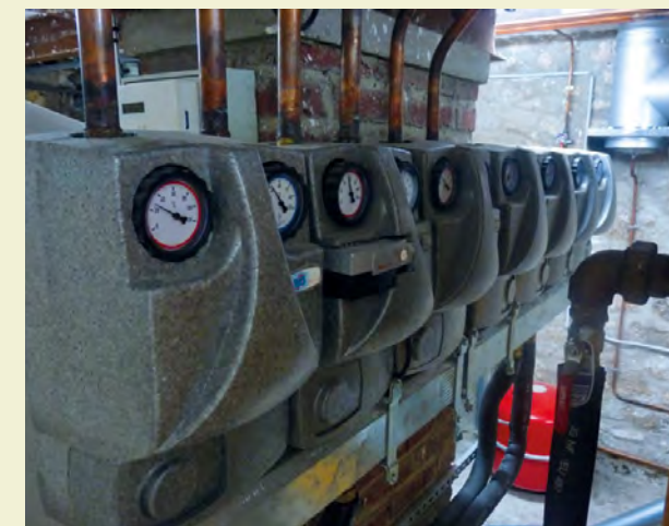
... et les compteurs d'eau chaude.
